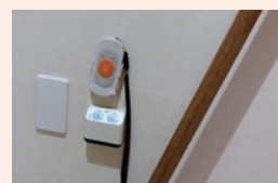
aams callボタン トイレ内に設置
