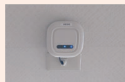
中継機/LANルーター 天井部に設置
